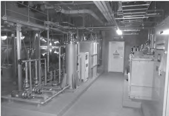
検査・感染系排水処理施設
